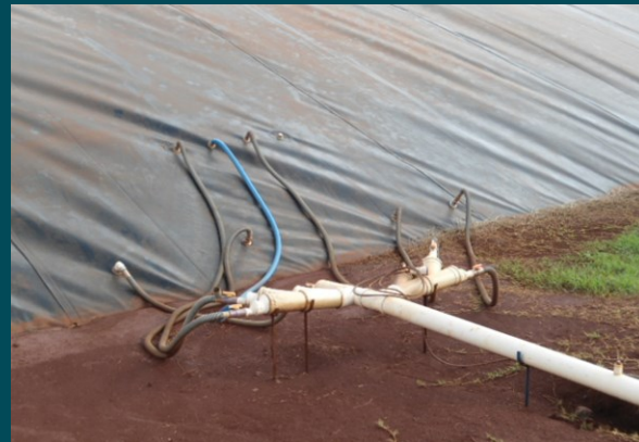
Flanges de captação do biogás
