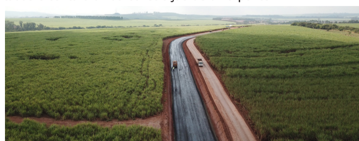
Trecho com obra em vicinais já iniciada em Rio Claro na região do Polo Cerâmico
