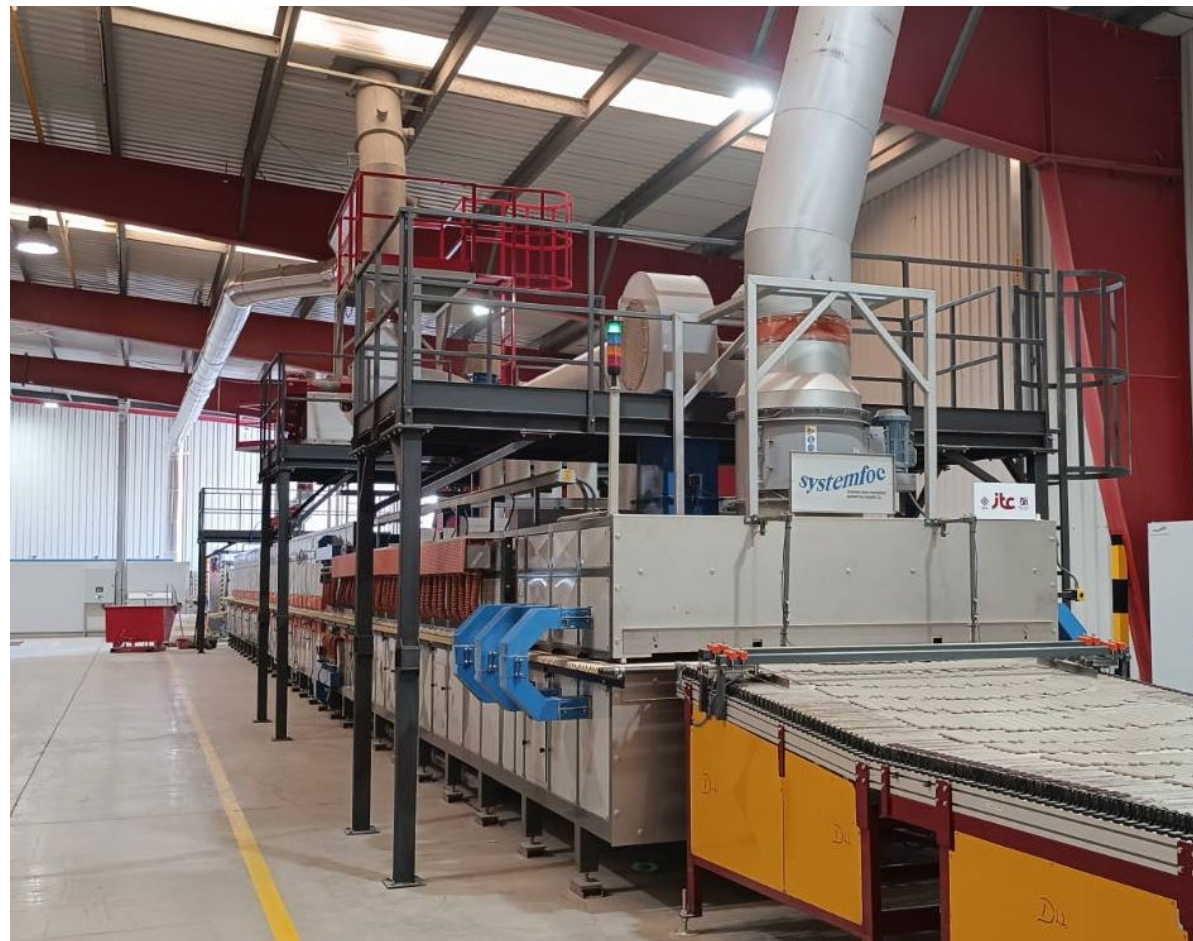
Forno elétrico industrial de rolos– 1.2 MW – 31m Setembro de 2024
