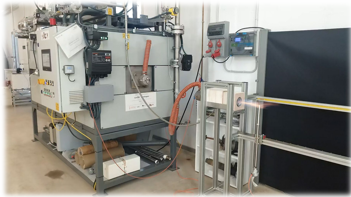
Câmara de combustão operacional com hidrogênio puro (100 % H 2 )
